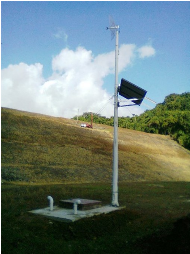
Figura 17. Estación sísmica instalada en la represa de Patillas (PDPR) (RSPR-UPRM).
